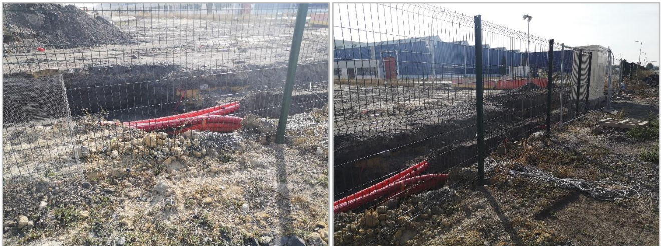
Photos 2 et 3 : Absence de grillage à l'extrémité sud de la barrière (Rainette, 2022).
